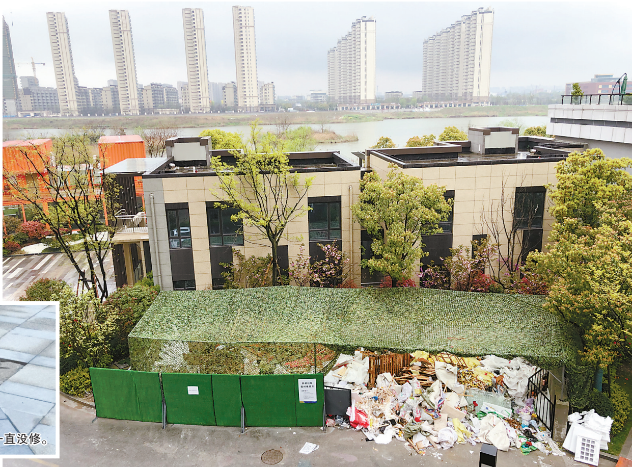
建筑垃圾堆放在居民楼前,不及时清理。
