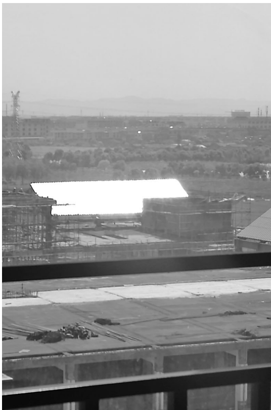
窗外的工地反射铁皮楼顶正对着居民窗户。
