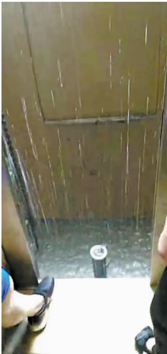
高楼水管弄断后喷水,电梯里如下雨。
