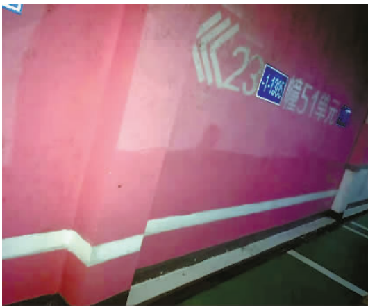
海曙中梁壹号院,地下停车库墙面色差可见。
