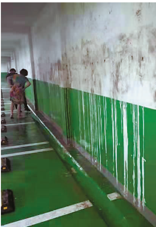
余姚中梁九号院地下车库墙面上打满了注浆孔修补。
