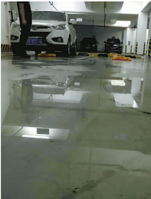
象山海御官邸小区地下车库潮湿积水。
