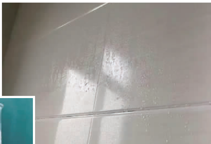
▲墙壁因潮湿出现小水珠。
