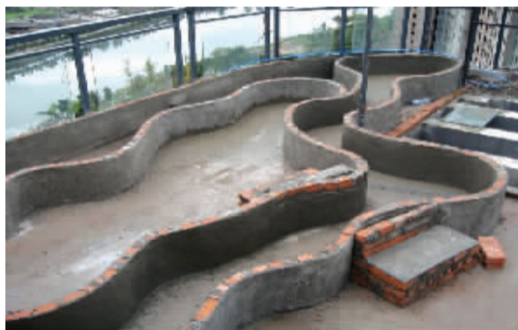
20楼弯弯曲曲的水道内外都已粉糊了水泥砂浆
